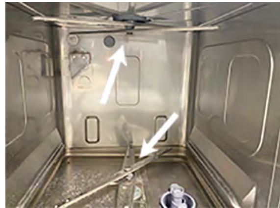
Photo 15 Lavage et rinçage des bras
