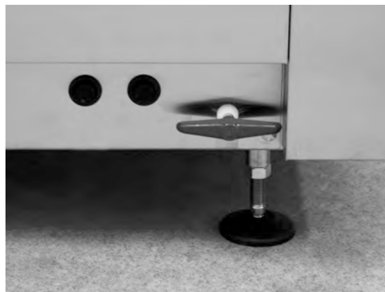
Photo 22 Accès à la protection anti-surchauffe
