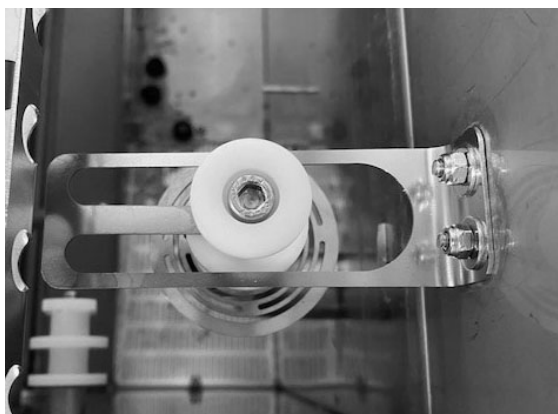
Photo 40 Robinet du trop-plein
